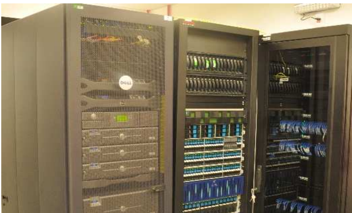
Figura 12 - Ilustrativa data center
